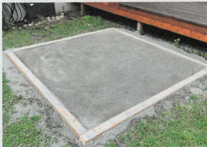
Exemple d'installation sur poussière de roche
